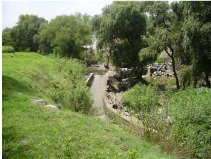
OBRA DE TOMA DEL CANAL LOS CASTORES, EN EL CAUCE DEL RÍO EL SALTO, COMPUESTA POR UN CANAL RECTANGULAR DE CONCRETO
