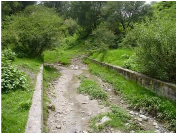
PUENTE – CANAL, EL CUAL RECIBE EL ESCURRIMIENTO PROVENIENTES DE LA ZONA ESTE, PARA SU DESCARGA EN EL RÍO TULA
