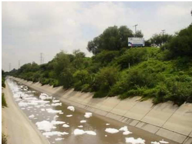
VISTA PARCIAL DE LA MARGEN DERECHA DEL CANAL EL SALTO - TLAMACO, EN LA ZONA DONDE SE ALOJARÁ LA OBRA DE DESVÍO
