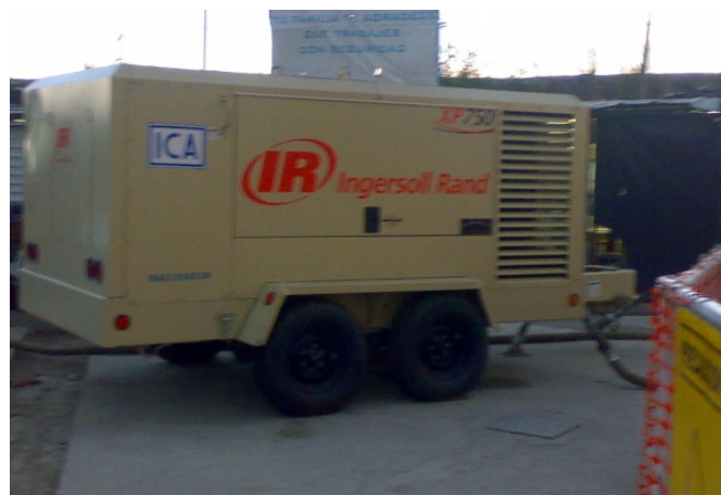
Fig. 2.5.10 Compresor para suministro de aire a presión
