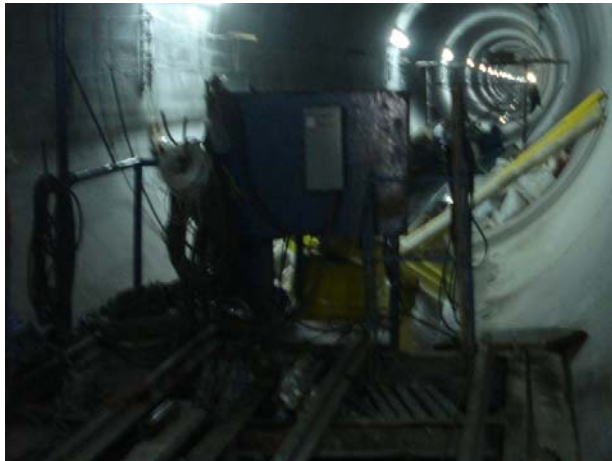
Fig. 2.5.7 Plataforma del distribuidor de concreto (Snorkel)
