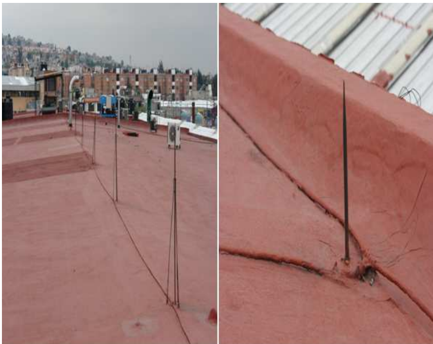
Figura 4.41. Sistema de pararrayos
