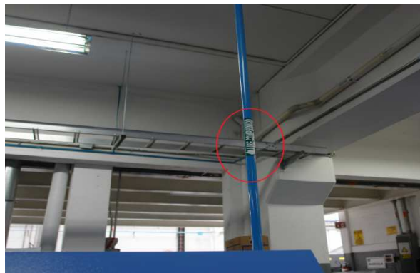
Figura 4.22. Señales en las tuberías.
