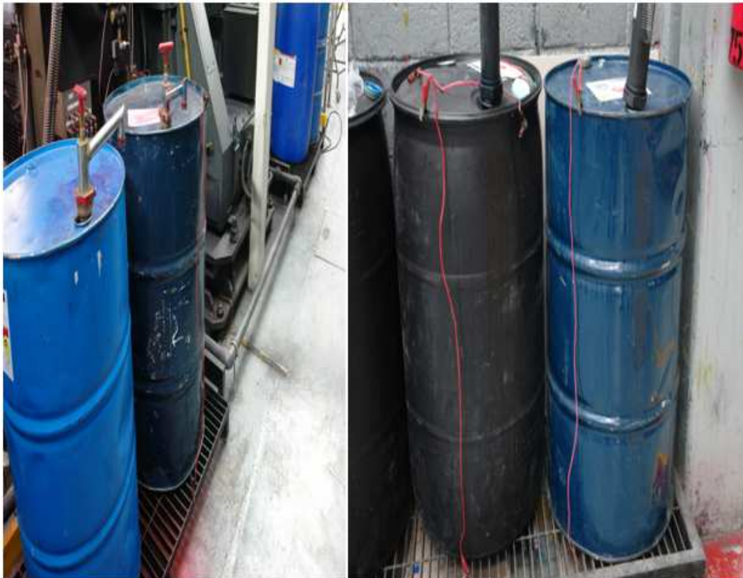
Figura 4.40. Puestas a tierra
