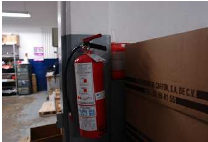
Figura 2.5. Equipo portátil contra incendios extinguidor de mano. .
