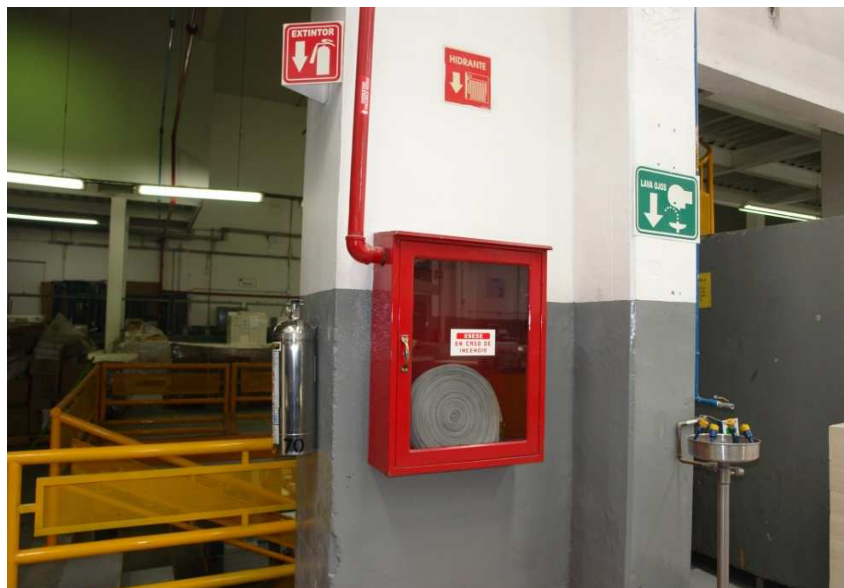
Figura 4.12. Hidrante dentro de la planta.
