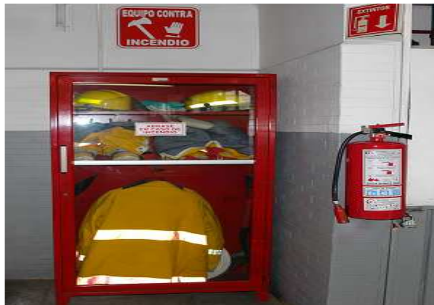
Figura 4.14 Gabinete de equipo para el combate contra incendio.
