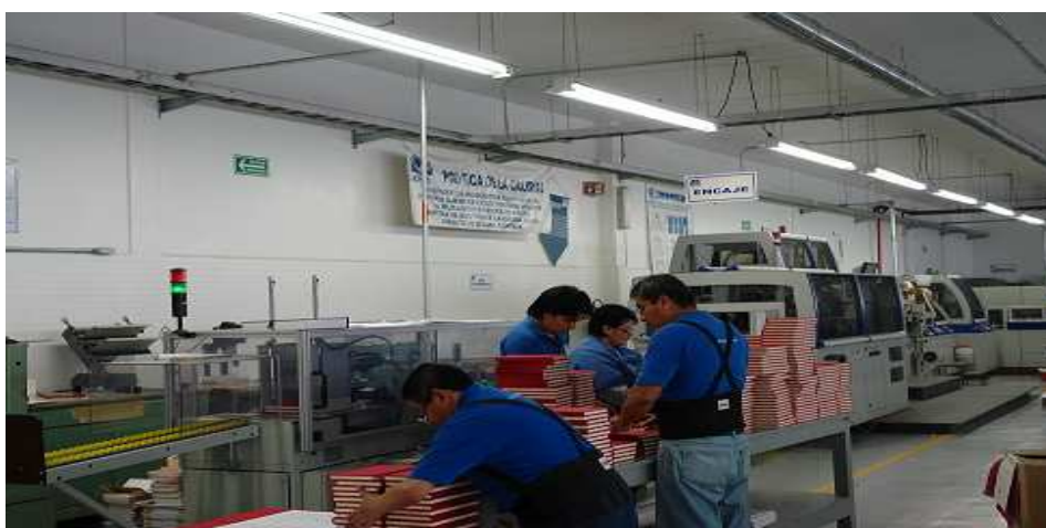
Figura 4.43. Luminarias en centros de trabajo.
