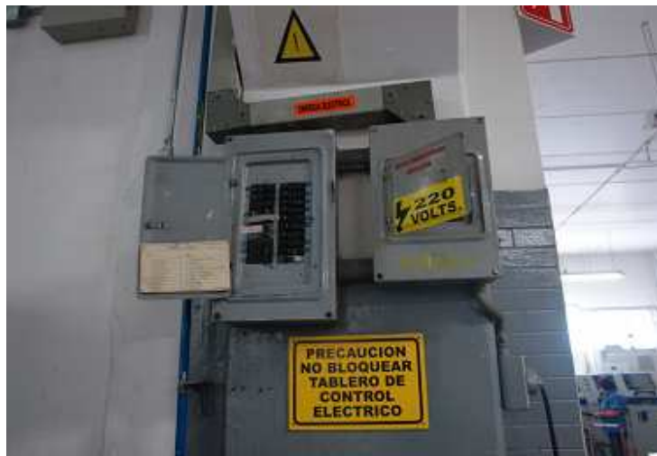
Figura 2.1. Tablero de Control.
