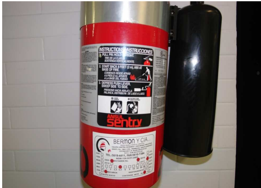
Figura 4.11. Extintor con sus características.
