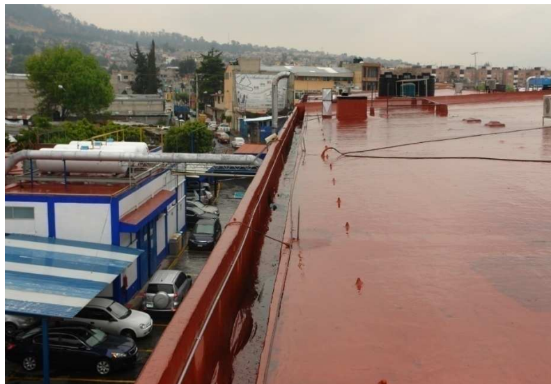
Figura 4.3. Techos impermeabilizados y canaletas que evitan el estancamiento de agua.
