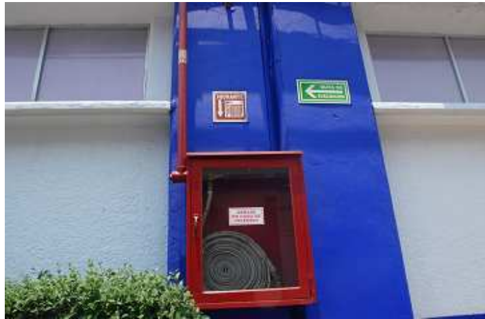
Figura 2.6. Equipo fijo contra incendio.
