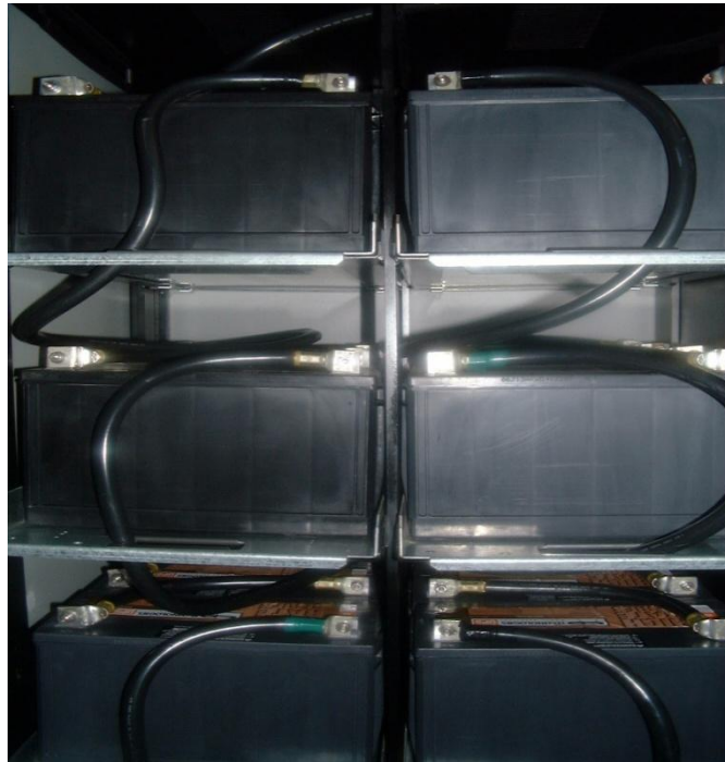
Ubicación de banco de baterías
