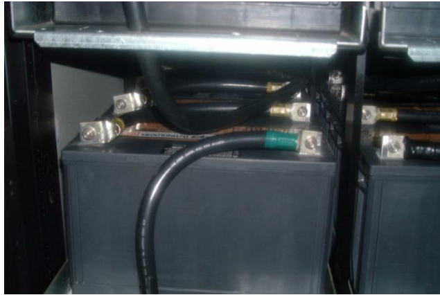
Terminales de baterías y conexiones
