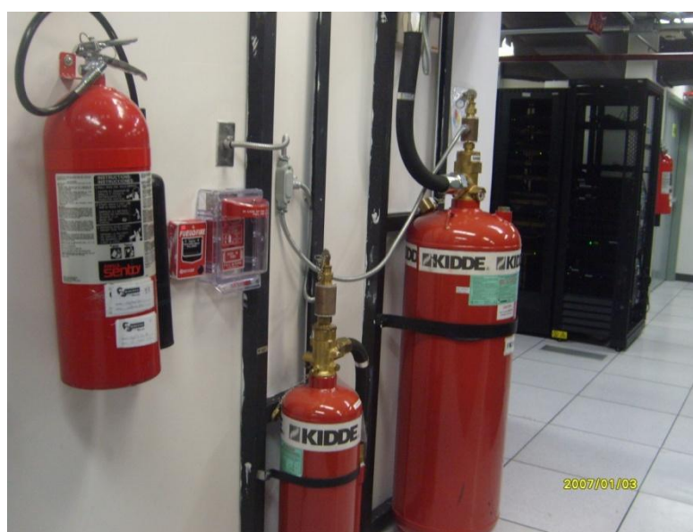
Sistemas de extintores para SITE
