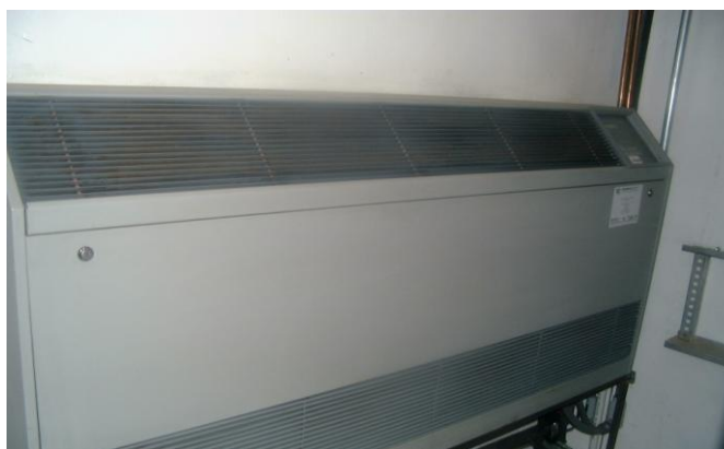
fig. 4.34 Aire acondicionado de precisión marca Liebert
