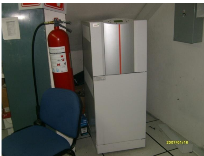
Cuarto de UPS en condiciones no aptas
