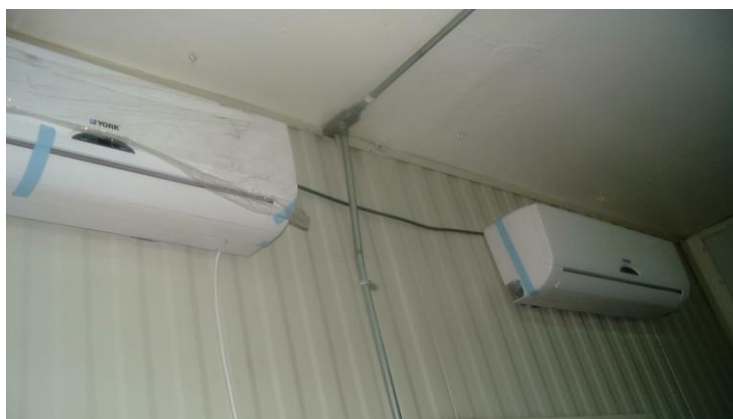
Fig. 4.33 Equipos de aire acondicionado de confort Marca York
