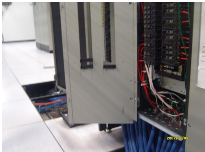
Fig. 4.29 Tablero de distribución de energía regulada
