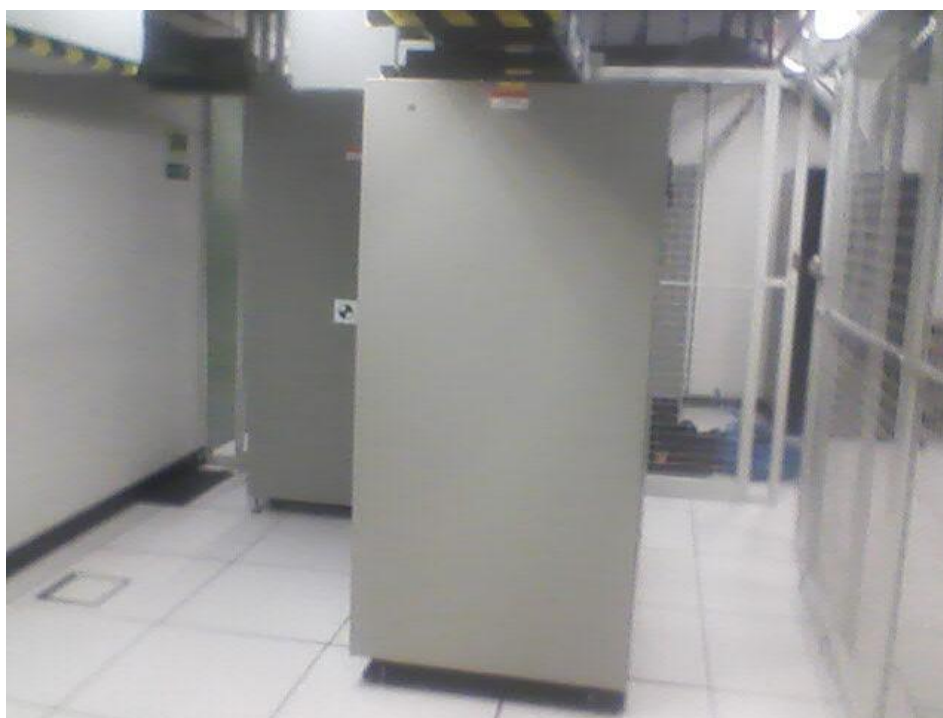
Cuarto adecuado para UPS
