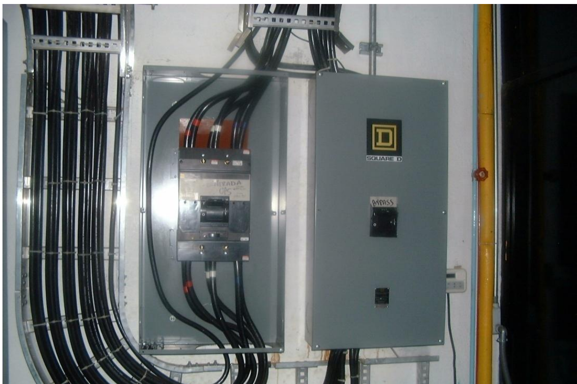
Interruptores generales con tapa y sin tapa
