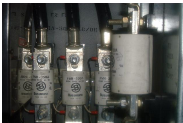
Fig. 4.30 Fusibles Bussmann de alta velocidad de respuesta
