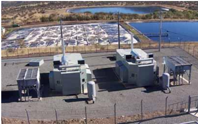
Figura 2. Imagen panorámica de motores de generación eléctrica, Relleno Loma Los Colorados, Chile. Portal de descontaminación Industrial y Recursos Energéticos, (s.f.). Consultado en Octubre de 2010, de: http://www.induambiente.com/ltimas-noticias
