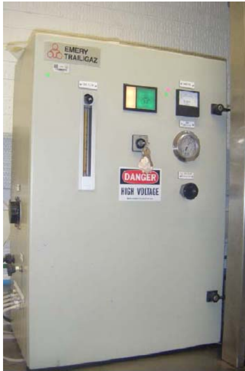
Figura A.4.1 Generador de ozono
