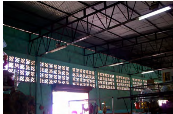
Es un sitio oscuro y sofocante debido al techo de lámina en grave deterioro.
