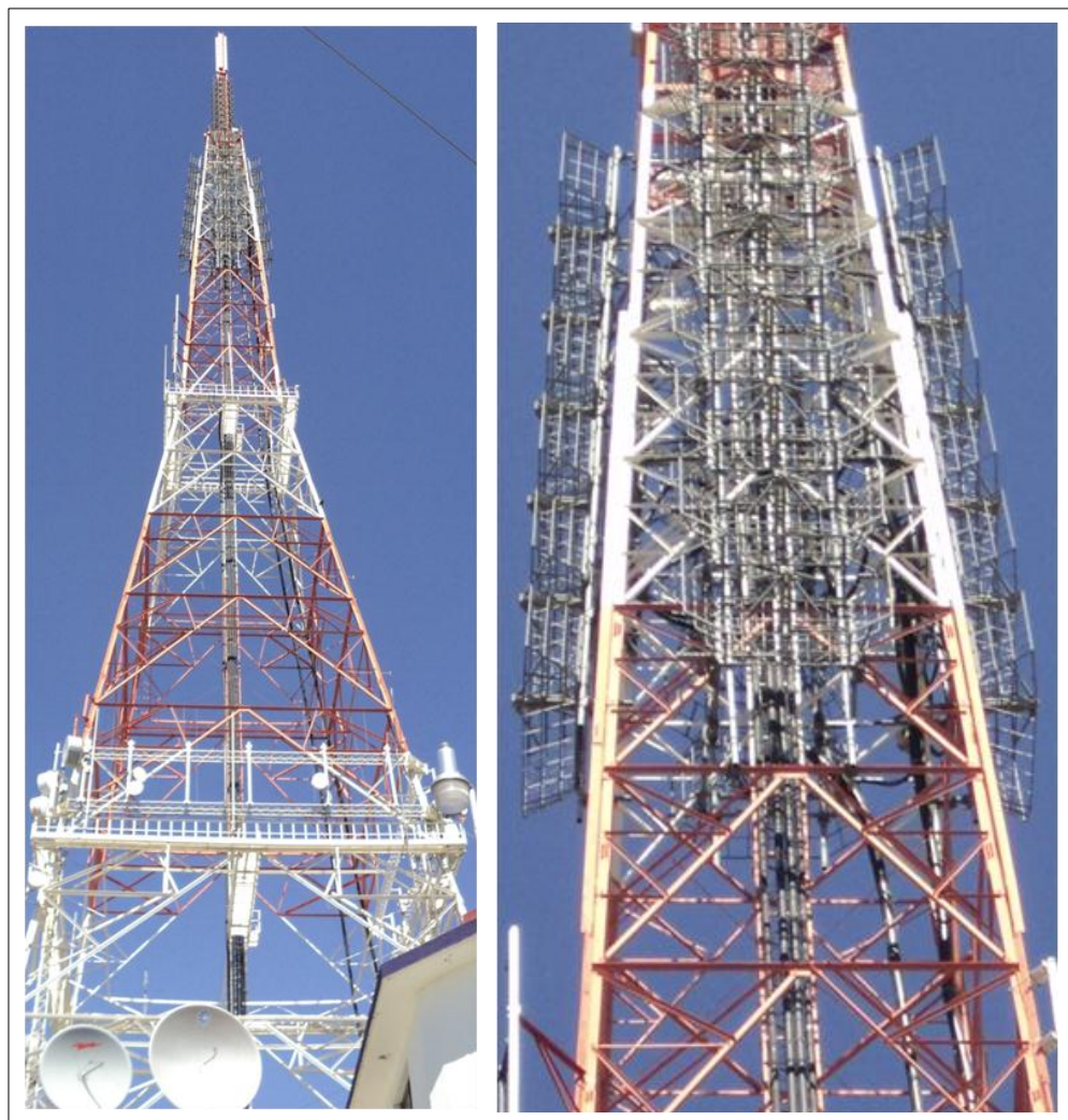
Figura 3.13. Torre (izquierda) y arreglo de antenas (derecha).
