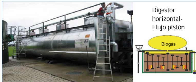
Figura 2.3 Digester horizontal (Ostrem, 2004)
