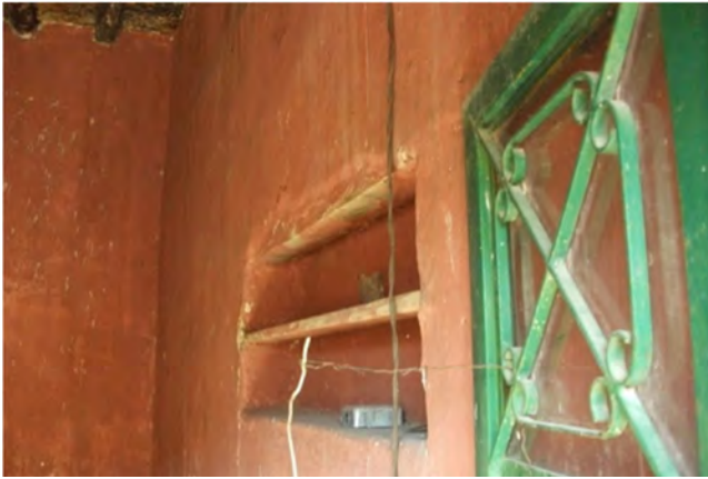
Vivienda en abandono con estantes entre muro
