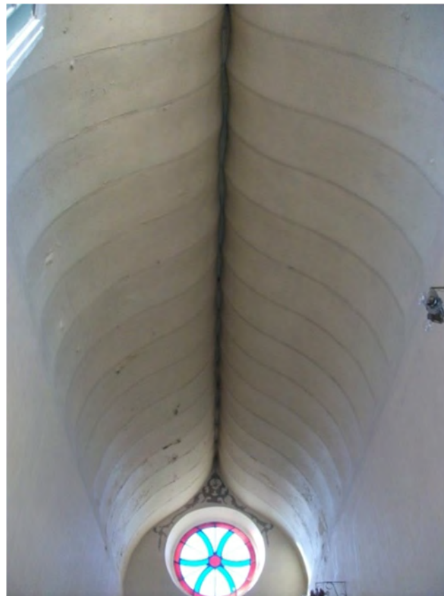
La peculiar cubierta de la capilla necesita ya mantenimiento
