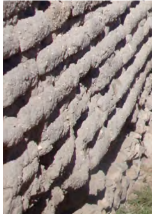
Muro viejo de adobe
