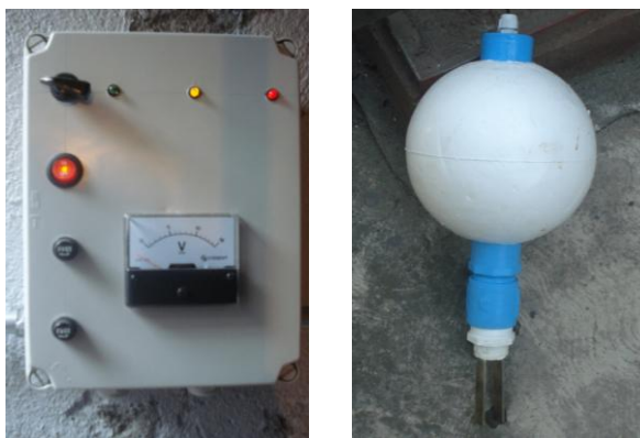
Figura 5.8. Dispositivo automático dosificador de iones de plata para tanques de almacenamiento.
