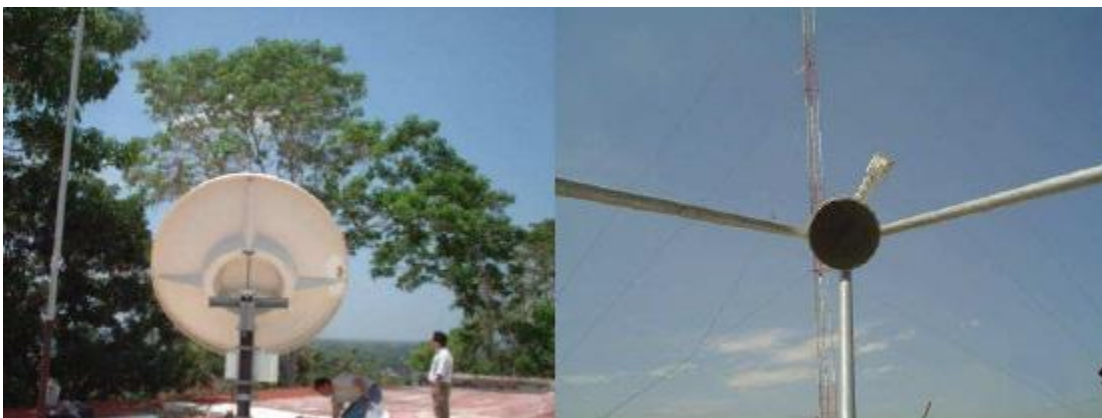
Figura 5.2. Antenas con obstrucción hacia el satélite.
