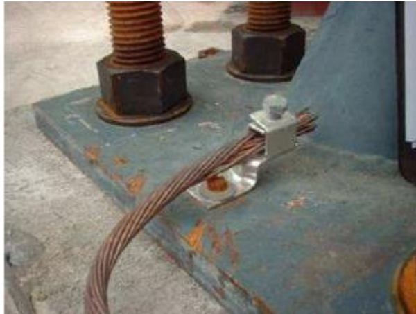
Figura 5.4. Conexión a tierra de la base de la antena.
