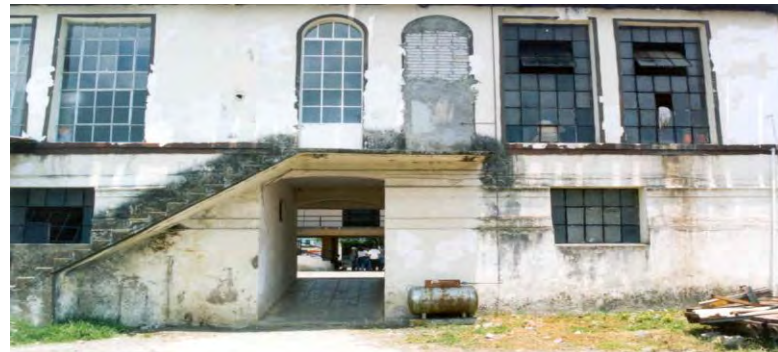
Fachada posterior deteriorada
