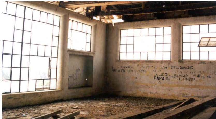
Deterioro del muro
