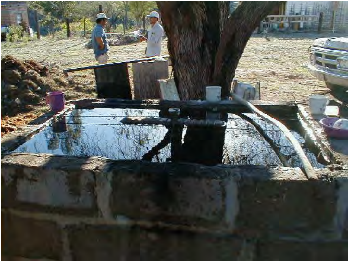
Fig. 122. El condensador que tienen en Opodepe, Sonora, es un radiador de un auto marca Dodge 1986 y se encuentra en una pila de condensación hecha con ladrillos.
