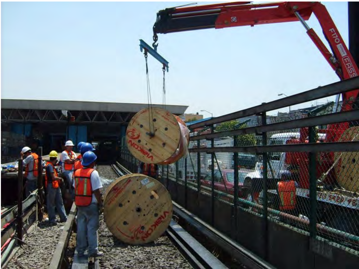
Figura III.35 Colocación de rollos de cable de 23 kv en el interior de la línea.
