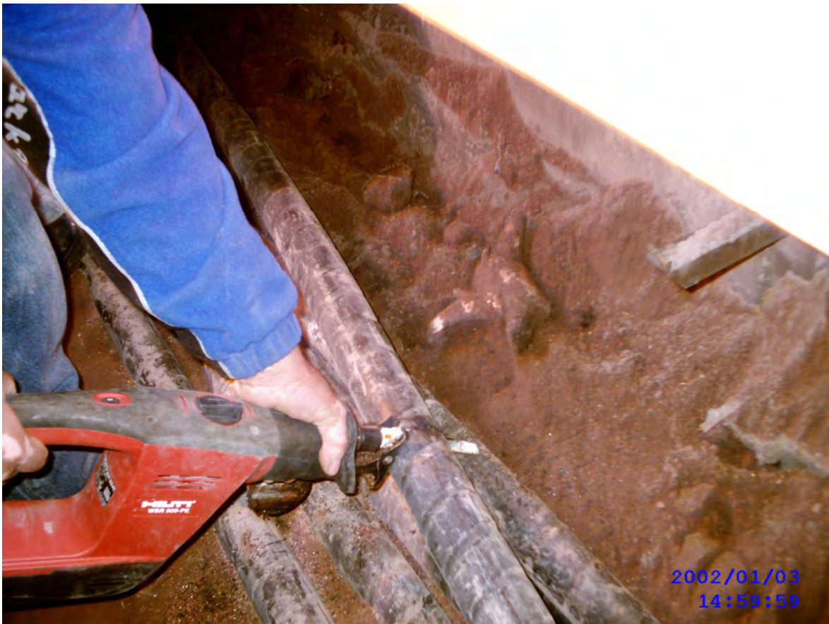
Figura III.6 Corte en secciones de cable tripolar fuera de servicio embebido en arena térmica.
