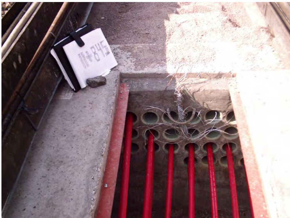
Figura III.41 Cables de 23 kv en interior de ductos de PVC de 4"
