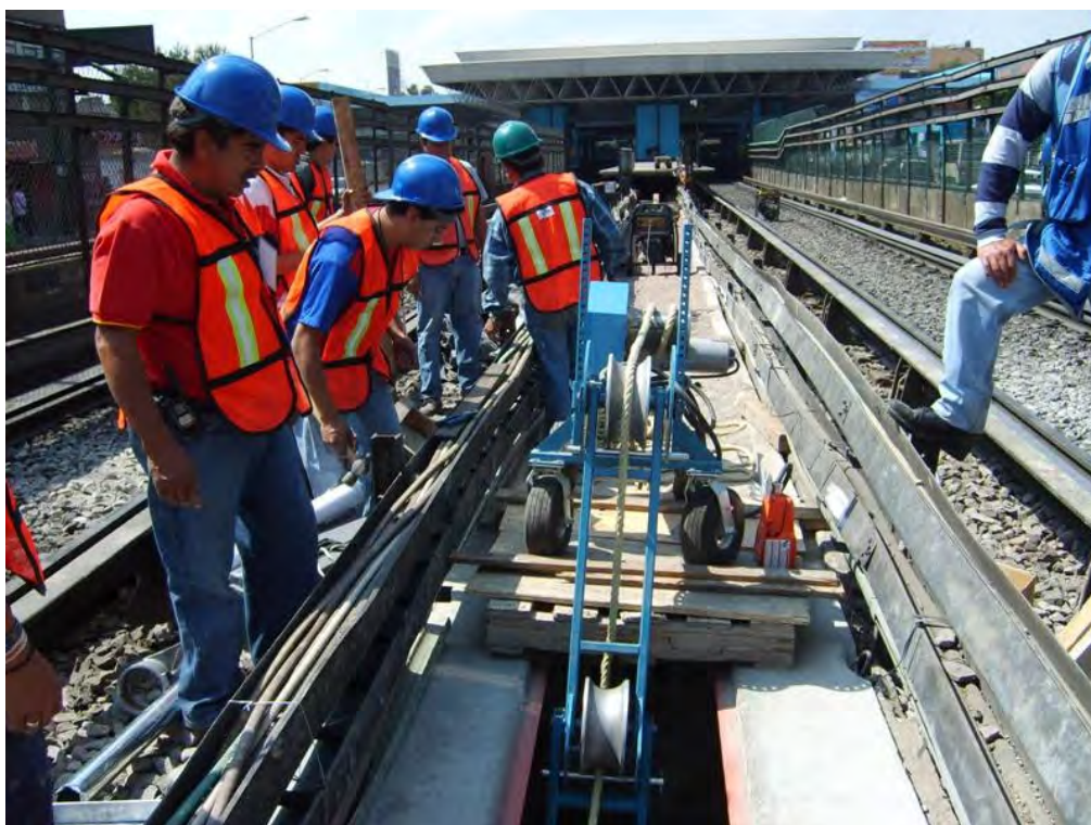
Figura III.39 Malacate eléctrico para el jalado del cable con una fuerza y velocidad constante.
