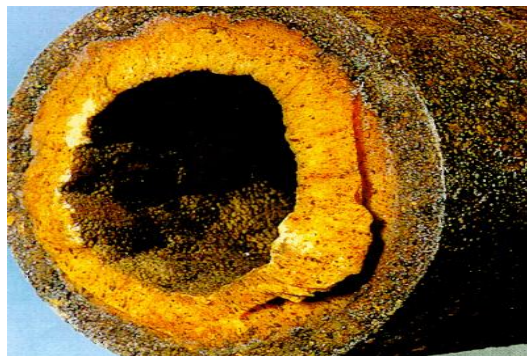
Fig. II.3 Sección de tubería taponada por deposición de parafinas
