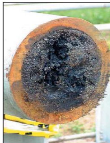
Fig. II.2 Sección de tubería taponada por deposición de asfaltenos
