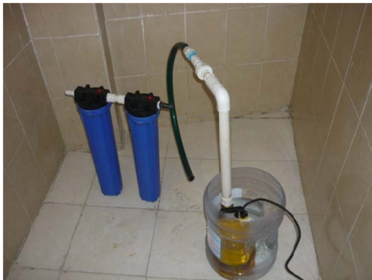
Figura 27. Tren de tratamiento, filtro de carbón activado + filtro de 50 \mu de papel celulosa
