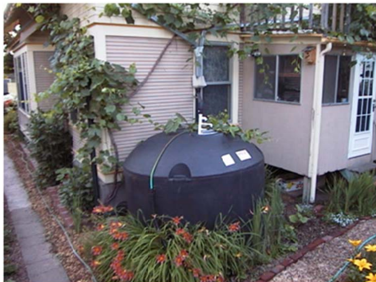
Figura 32. Sistema de Captación de agua pluvial al norte de Australia
