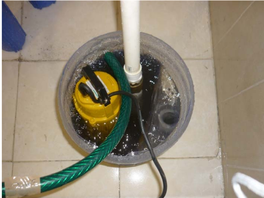
Figura 29. Bomba sumergible de 0.5 Hp, para bombeo de tren de tratamiento
