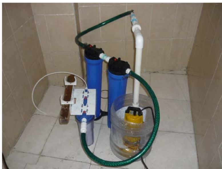
Figura 28. Tren de tratamiento, filtro de carbón activado + filtro de 50 \mu de papel celulosa + filtro de polipropileno de 10 \mu
