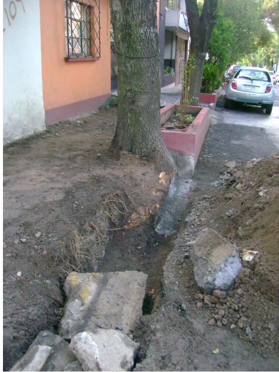
Figura 3.- Afectación del sistema radical del arbolado por obras.
