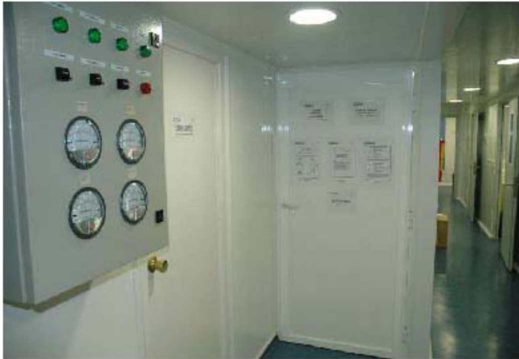
Figura 42. Controladores e Indicadores de Presión y Humedad dentro de un Área de Preparación en la Industria Farmacéutica. (www.icmicom.com/farmacia.jpg)
