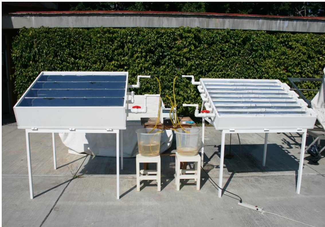
Figura 4.5. Fotografía de los captadores solares fabricados en el CIE-UNAM: 1 sol (derecha) y 2 soles (izquierda).
