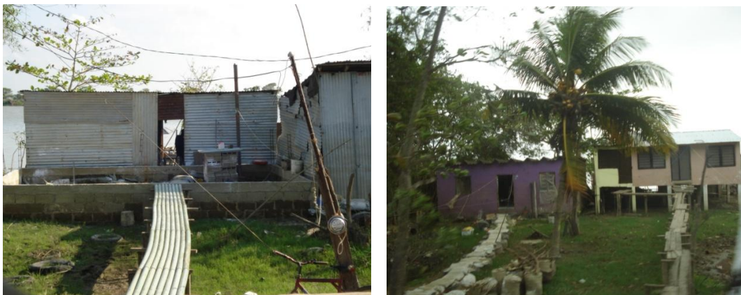
Imagen 13 - Algunas de las casas construidas a lo largo del cauce del río Papaloapan, a la entrada de la Ciudad de Tlacotalpan, están construidas con materiales débiles como lámina y cartón, o sobre pilotes con mala estructura. Noviembre, 2010.
