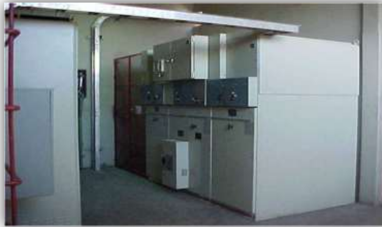
Figura2.18 Interior de subestación de rectificación.
