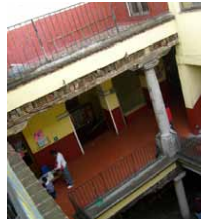
Vista del patio interior. Podemos ver el pórtico que sirve como circulación.
