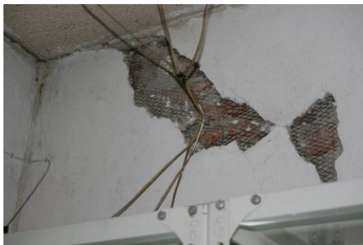
Img. 3 Deterioro de acabados
