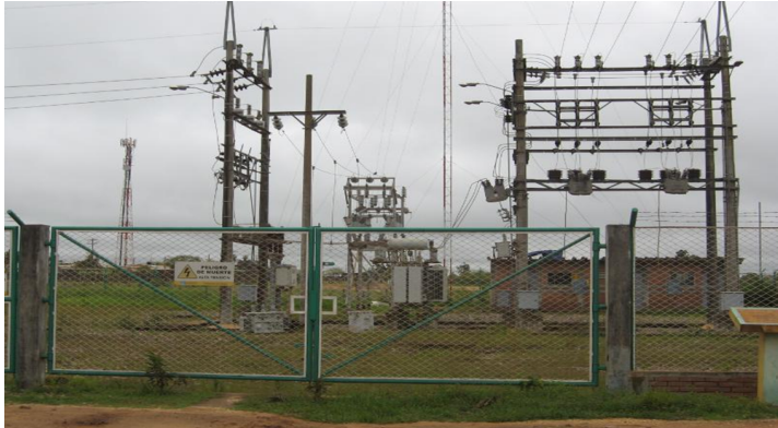
Figura 1.26: Sistemas de distribución, subestación Teotihuacán, Edo. de México.
