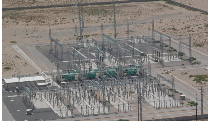
Figura 1.24: Modo de Transformación, subestación Río escondido, Coahuila.
