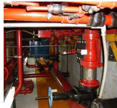
Estación contra incendios interna
