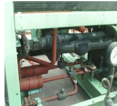
Estación contra incendios externa
