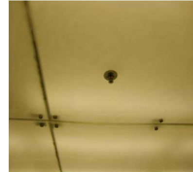
Rociador contra incendios
