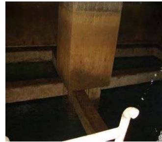
Cisternas ubicadas en primer nivel de sótano
