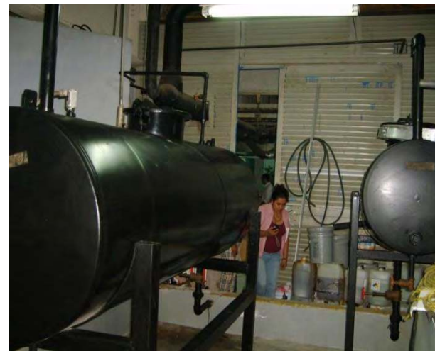
Caldera ubicada en nivel 7 de edificio
