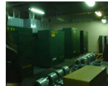
Fotos: Ocho transformadores de 300 Kva.,
