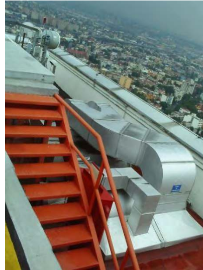
Ductos de sistema de despresurización
