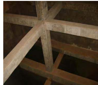
Cisternas ubicadas en primer nivel de sótano
