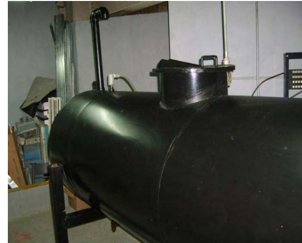
Caldera ubicada en nivel 7 de edificio
