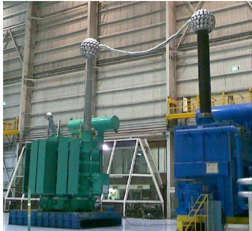
Figura 5-10: Pruebas a un reactor en industrias IEM.
