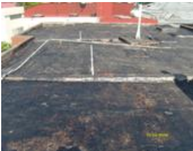
Fotografía 5. Se muestra la forma correcta de como debe quedar la superficie ya limpia una vez retirado el sistema anterior. Imprimación de la superficie.
