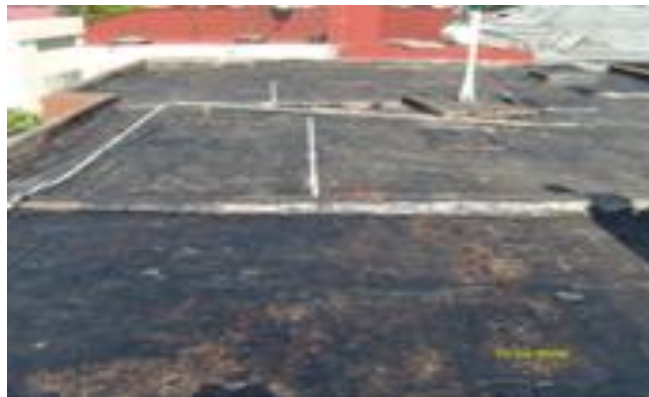
Fotografía 8. Nos muestra la forma correcta de cómo debe quedar la superficie ya limpia una vez retirado el sistema anterior.
