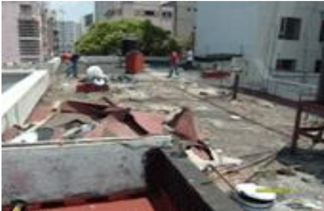
Fotografía 7. Nos muestra la forma correcta de como para la preparación de un nuevo sistema de impermeabilización es necesario retirar el sistema anterior, cuando este se encuentra mal adherido.
