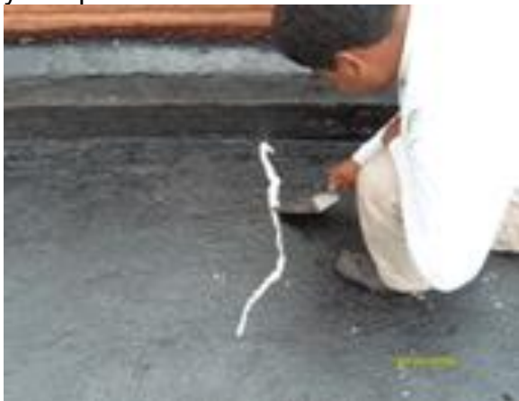
Fotografía 6. Se muestra la forma correcta en que debe quedar la imprimación y como después de haber secado el primario se procede a sellar las fisuras de la superficie a impermeabilizar.
