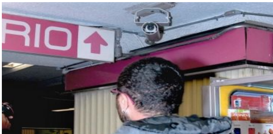
Cámara en el pasillo de la Línea 1.
