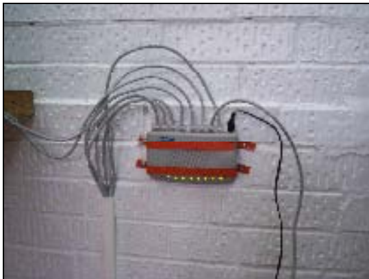
Figura 2.3. Switch Ethernet de 8 puertos
