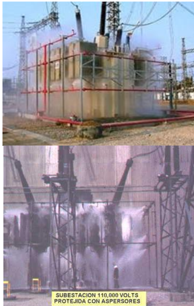
Fig. 3.16 Sistema de aspersores para la protección de transformadores
