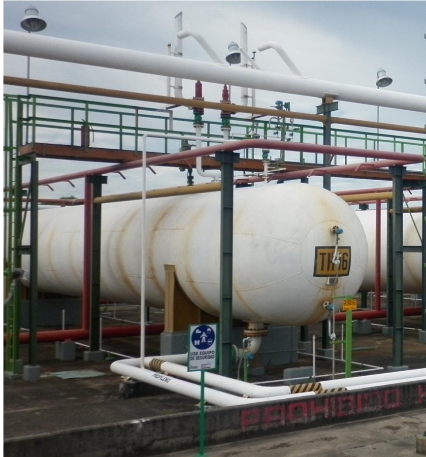
Fig. 7.15 Tanque de almacenamiento de propano.
