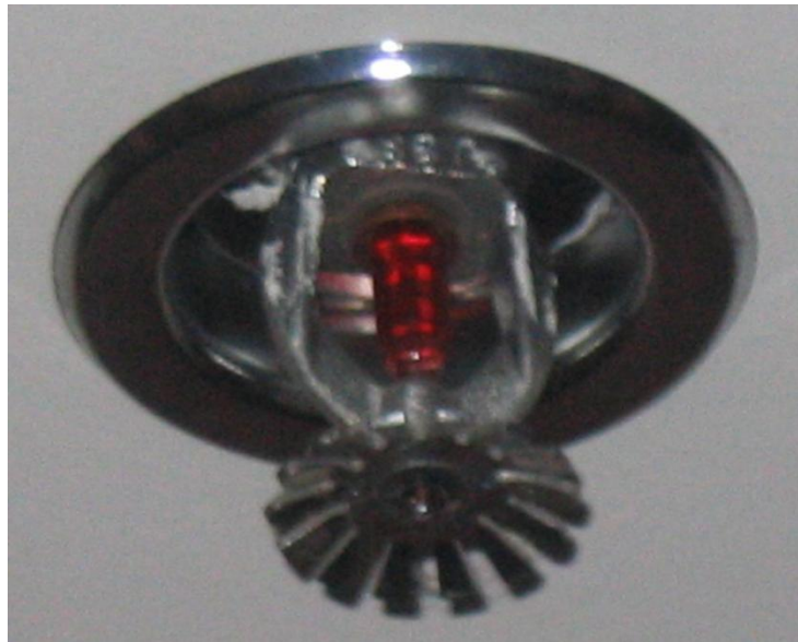
Fig. 3.10 Un rociador central del tipo rebaje
