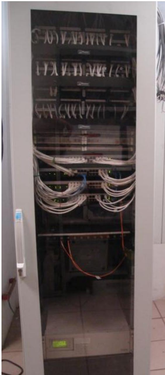
Figura 3.6a Rack Site Centro (Cerrado)
