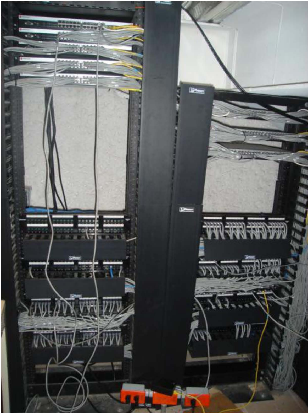
Fig. 3.7 Racks y equipos de Site 3
