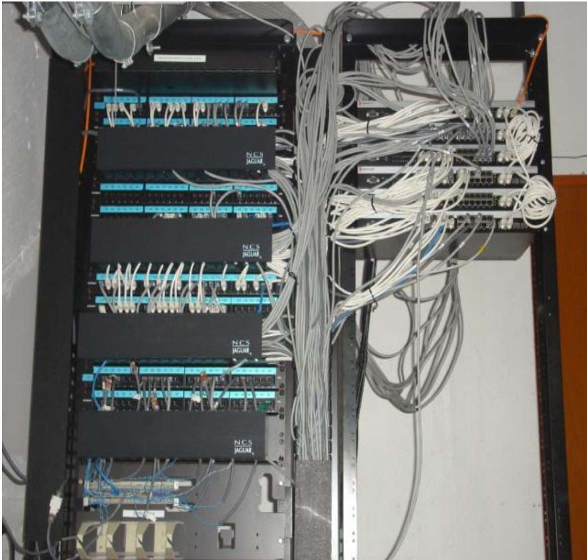
Fig. 3.8 Rack de Site 4
