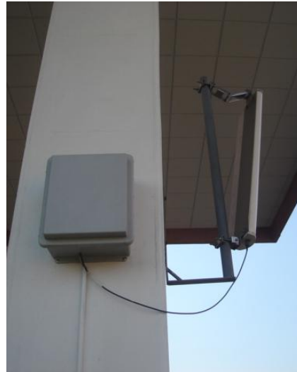
Fig. 3.12 Conexión de antena Sectorial al punto de acceso RoamAbout.
