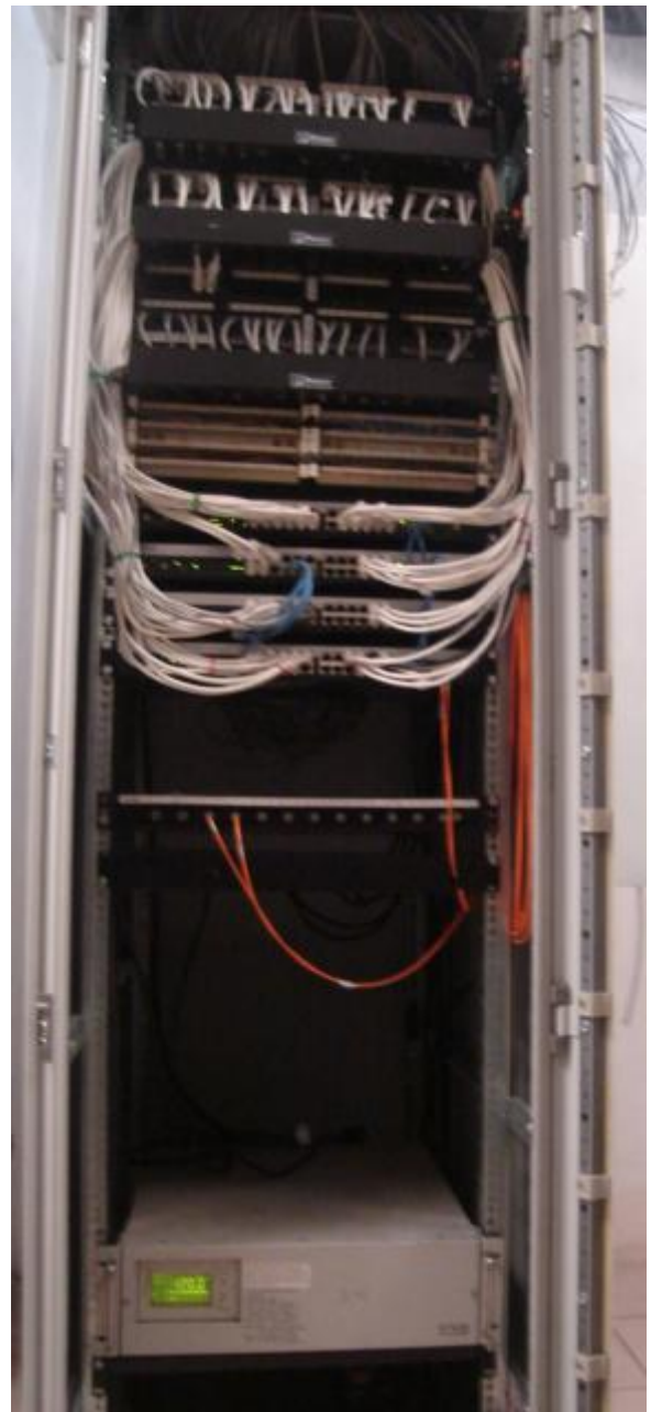
Figura 3.6b Rack Site Centro (Abierto)
