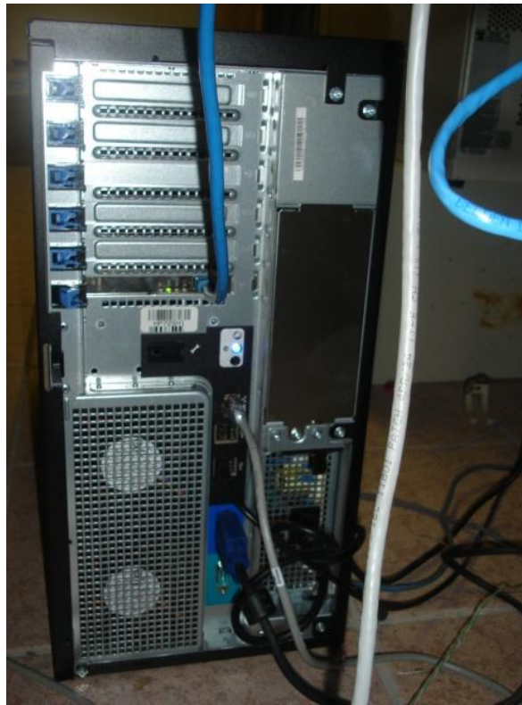
Fig. 3.18 Conexión de dos tarjetas del Servidor DHCP - Cable Gris conectado a la VLAN de inalámbrica – Cable Azul Conectado al segmento Institucional
