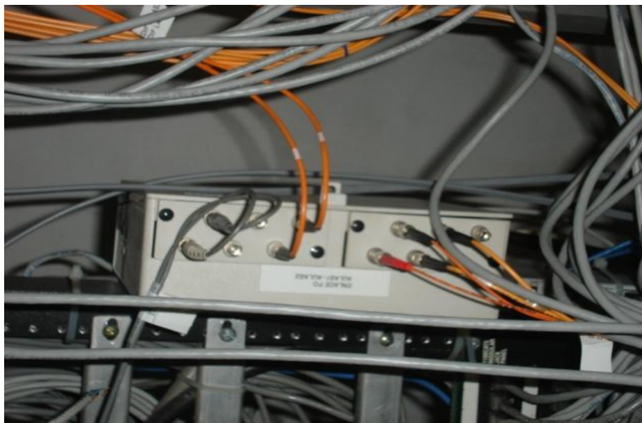
Figura 3.4 Distribuidor de Fibra óptica
