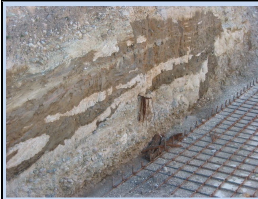
Figura 14. Imagen de una pared en la porción sur del Colegio, zona en donde se estaba construyendo un emparrillado. En la porción superior se aprecian gravas redondeadas en matriz arenosa fina, subyacidas por limos y arenas finas y mas abajo, gravas redondeadas
