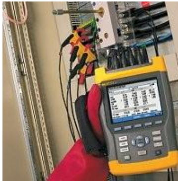
Fig. 3.8 Equipo analizador de redes y medición de energía
