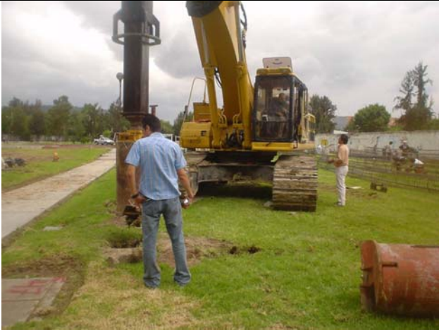
Se inicia la perforación de pila vez plomeada y centrada el bote de perforación
