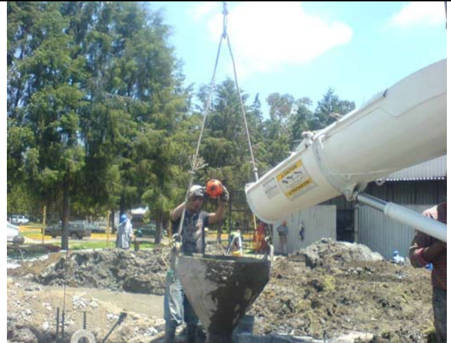
Se le agrega el tapón deslizante para llevar un adecuado para el colado de la pila.
