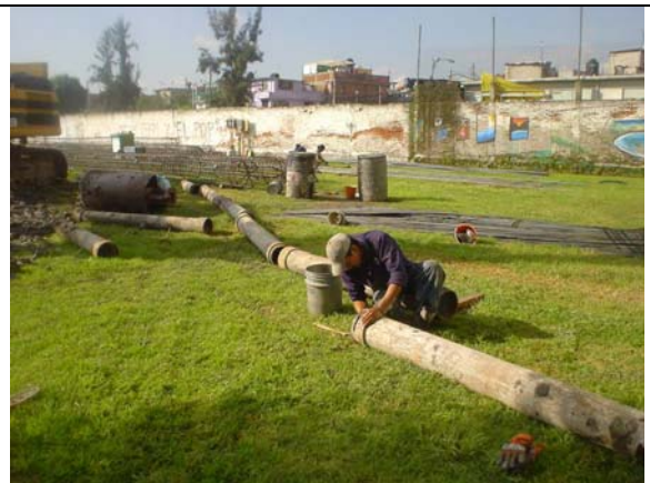
Tubería tremie de \text{Ø}=8'' . Se observa que la tubería no está limpia ni por dentro ni por fuera.
