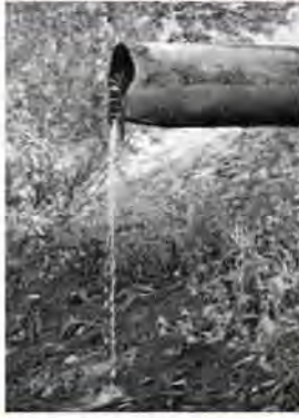
Drenaje a cielo abierto, México.
