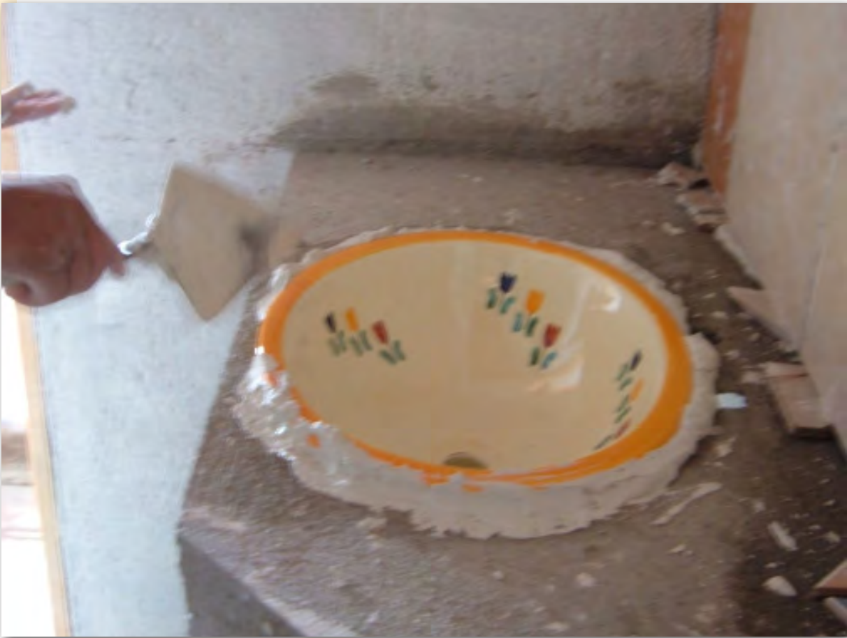
Figura 3|05. Instalación de lavabo artesanal.
