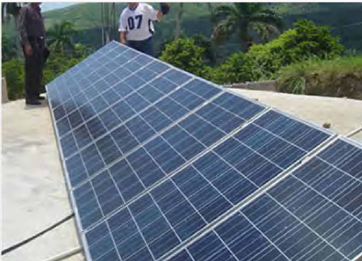
Figura 4|42. Paneles Fotovoltaicos colocados a cierta distancia para evitar sombras.
