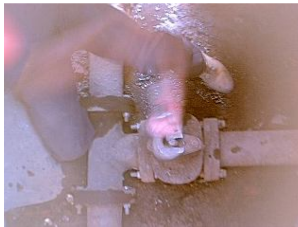
CIERRE DE VÁLVULAS
