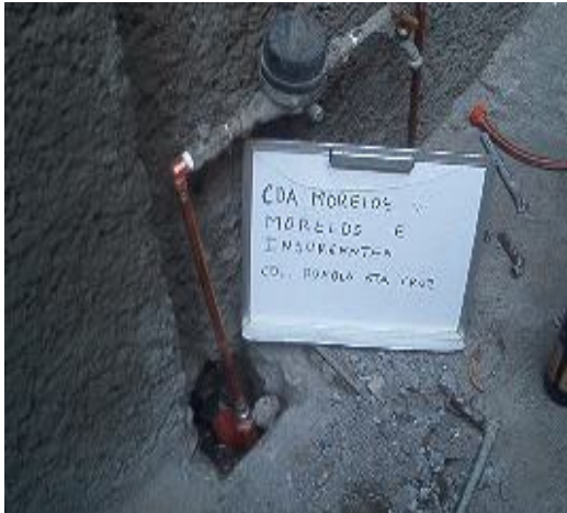
CONEXIÓN A CUADRO DE MEDIDOR (FOTOGRAFIA No 59)
