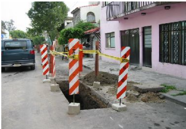
SEÑALIZACIÓN EN VENTANA DE LANZAMIENTO
