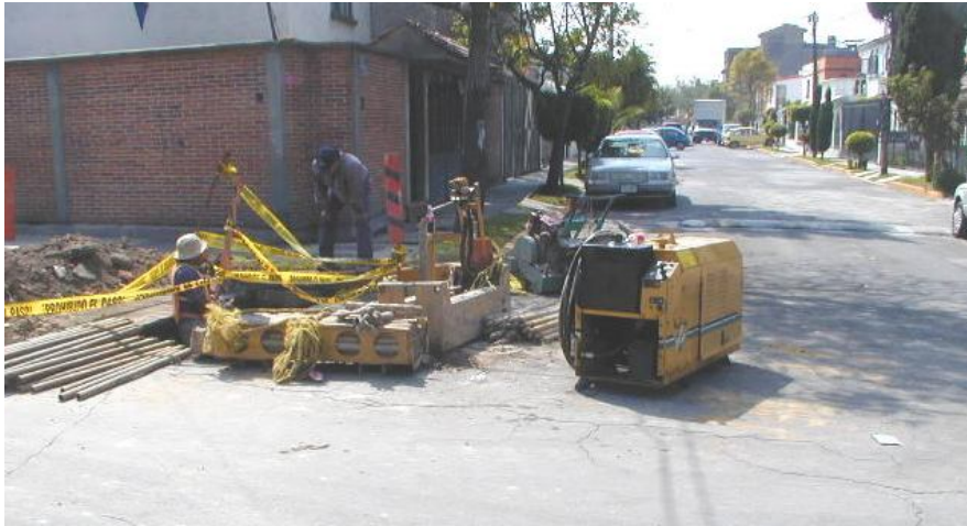
FUENTE DE PODER, UNIDAD DE IMPULSO HIDRÁULICO, BARRAS DE ACERO Y ALMACENAJE.
