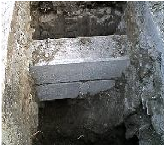
DUCTOS DE TELEFONÍA FOTOGRAFIA No 10
