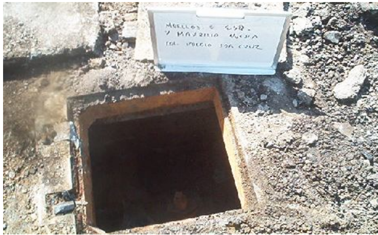
CAJA DE VÁLVULAS DESCUBIERTA BAJO ASFALTO
