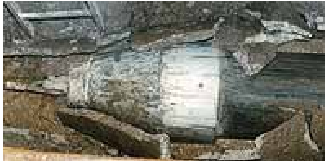
GOLPETEO DE MARTILLO EN TUBERÍA DE ASBESTO- CEMENTO
