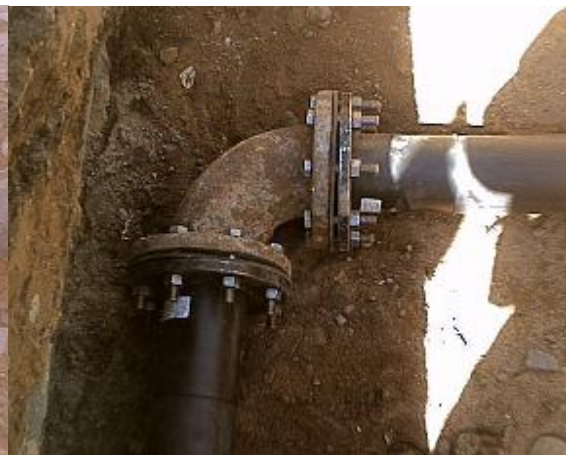
CONEXIÓN A CODO DE FO.FO. (FOTOGRAFÍA No 66)
