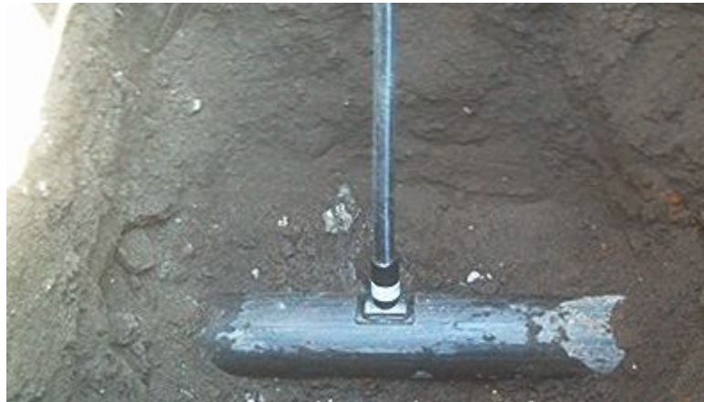
SILLETA Y TUBERÍA TERMOFUSIONADA (RAMAL)
