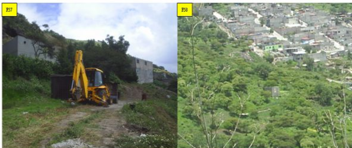
Fotografías: No. F57 Maquinaria pesada empleada en la construcción y F58 Crecimiento de la comunidad hacia áreas verdes de la Sierra de Guadalupe.
