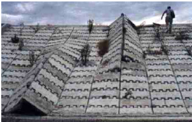
Figura 1.2 Dislocaciones en los elementos de concreto del revestimiento de un canal en Taiwan, sismo del 21 de septiembre de 1999 (Romo, 2005)
