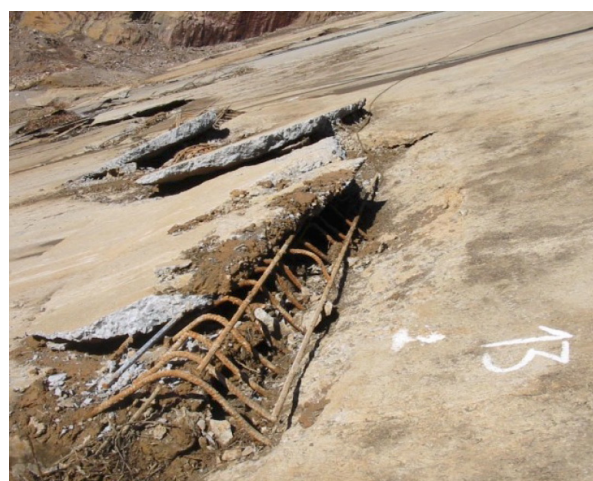
(b) Grieta horizontal
