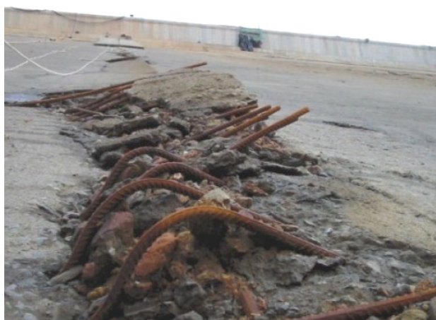
(a) Junta vertical entre las losas 16 - 17
