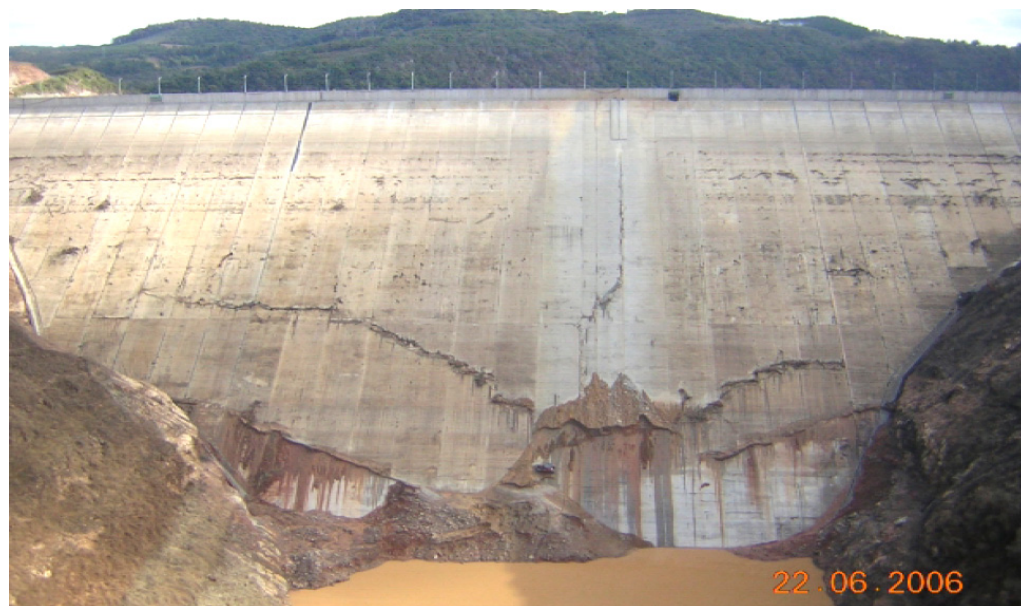
Figura 3.32 Aspecto de la cara de concreto después del vaciado del embalse, Presa Campos Novos, Brasil (Xavier et al., 2007)
