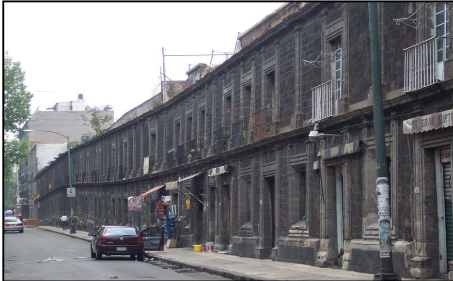
Figura 4: Calle del Centro Histórico que presenta hundimiento.
