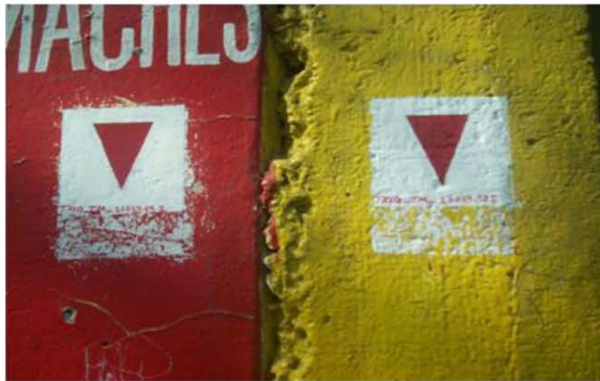
Fig. 1.7. Testigos en muros (palomas)
