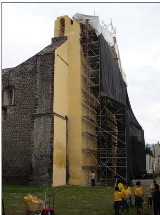
Imagen 93. La fachada de San Bernardino de Siena fue pintada con base en su color original, 2005. Fuente: Archivo particular de Fernando Chiapa Sánchez.
