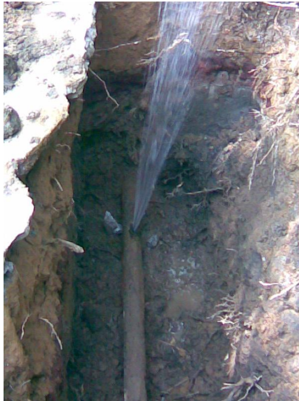
Imagen 4: Fuga detectada en la Facultad de Odontología (La Muela) Fuente: PUMAGUA (Foto: Maricela Ojeda) 25 de agosto 2010
