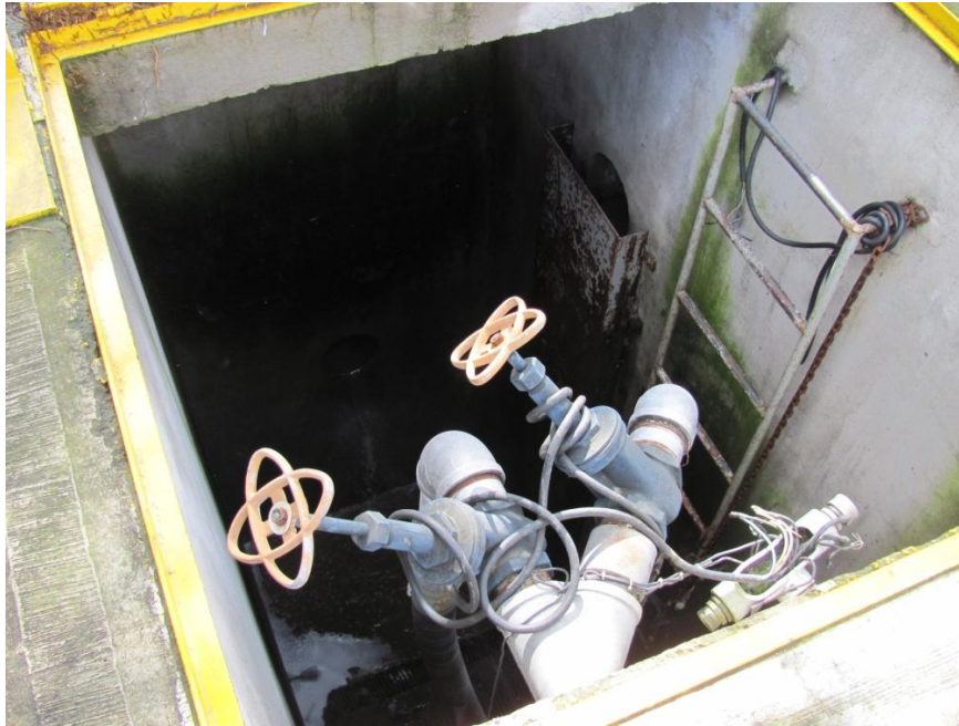
Imagen 1: Cisterna de aguas negras de la planta de tratamiento FCPyS Fuente: PUMAGUA (Foto: Wendy Mortera Ruenes) 19 de agosto 2010
