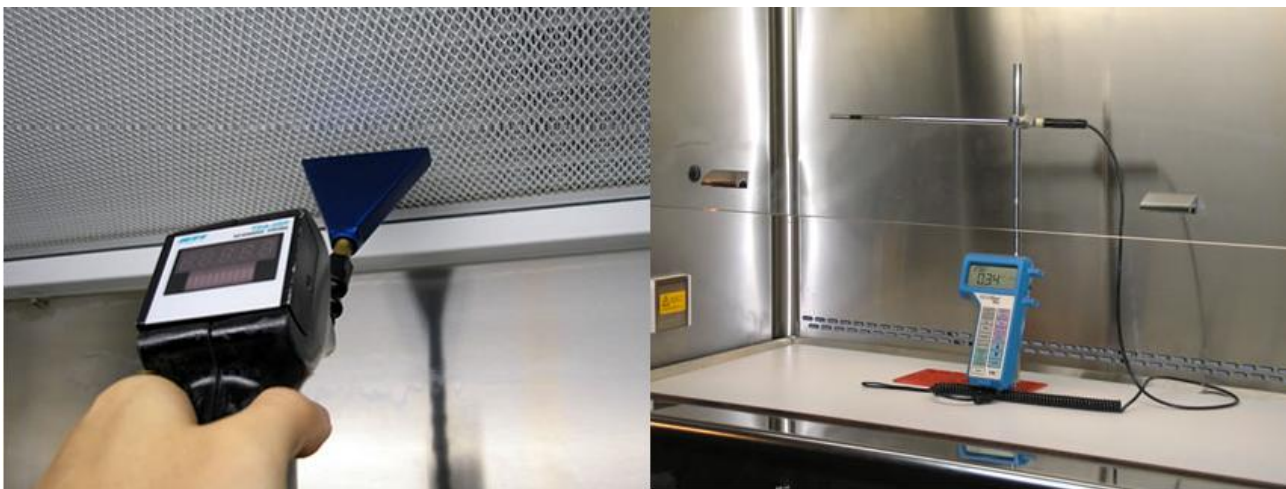
FIGURA 8. ENSAYO DE UNIFORMIDAD DE AIRE (VERIFICACIÓN DEL CORRECTO FUNCIONAMIENTO DE LOS FILTROS HEPA).
