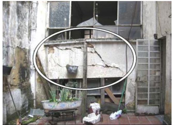
Foto 2. Agrietamiento y pérdida de horizontalidad
