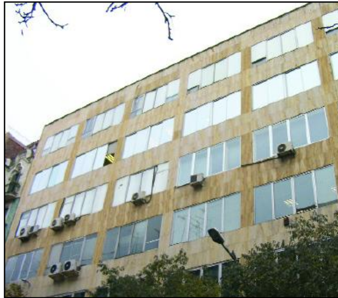
Foto IV.4. Suciedad en fachada de edificio debido a equipos de aire acondicionado que originalmente no estaban proyectados.
