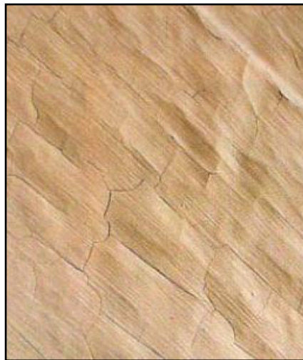
Foto IV.10. Ampollas y cuarteamiento de la pintura aplicada al paramento.
