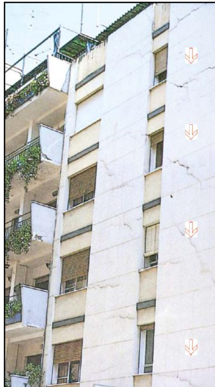
Foto IV.1. Movimiento diferencial en un edificio donde se ve claramente las grietas.
