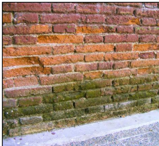
Foto IV.7. Manchas, deterioro y pérdida de material debido a la humedad
