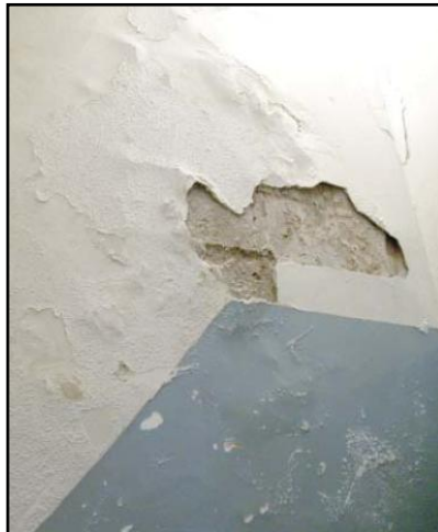
Foto IV.8. La aparición de humedades ha provocado la pérdida del aplanado y el deterioro de la pintura
