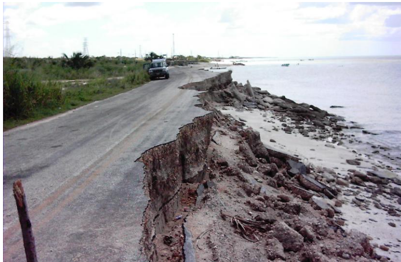
Figura 158. Erosión de carretera en Boca Sabancuy.
