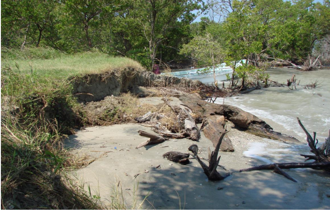
Figura 80. Playa Punta la Disciplina con destrucción de manglar por erosión.
