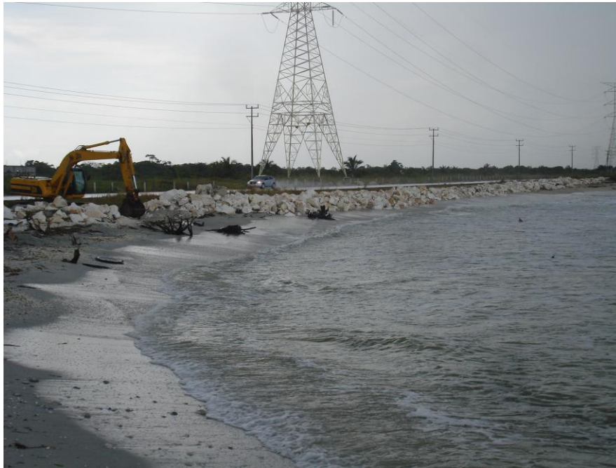
Figura 86. Escape de erosión presente en la playa CONANP 2.
