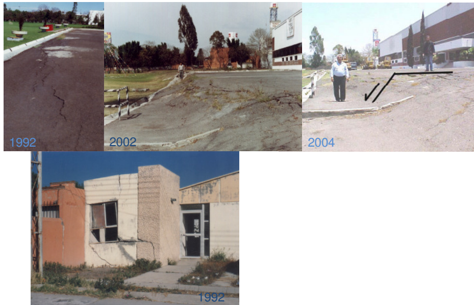
Figura 2.23. Evolución del agrietamiento y fallamiento en el AVQ
