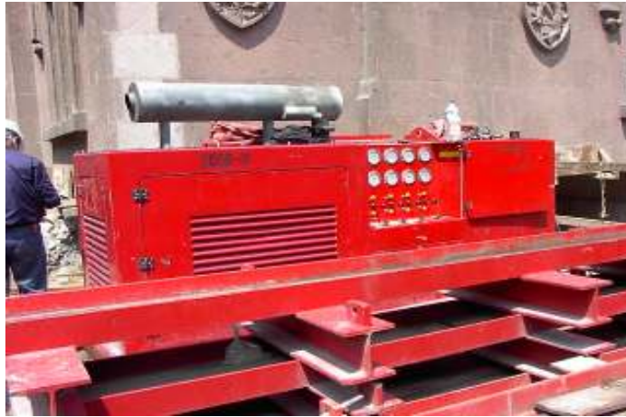
Figura 43. Generador hidráulico usado en el movimiento de la casa para operar equipos hidráulicos.
