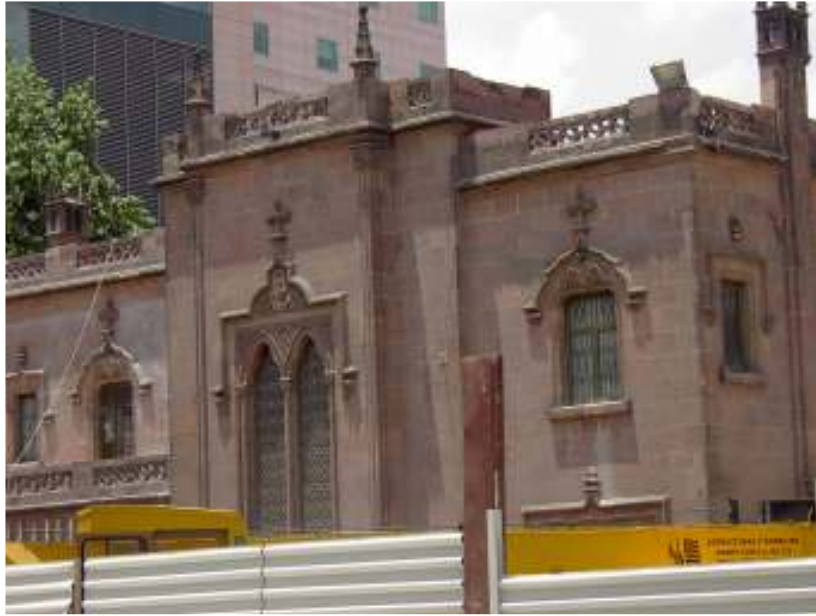
Figura 8. Detalle de la piedra de cantera.
