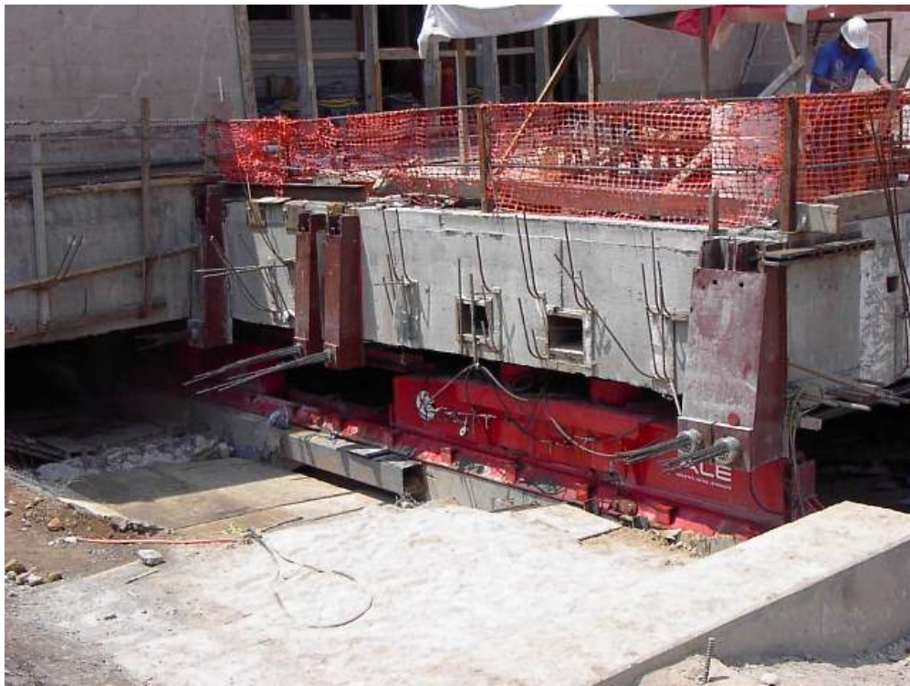
Figura 55. Cables de presfuerzo trabajando, vista fachada oriente.
