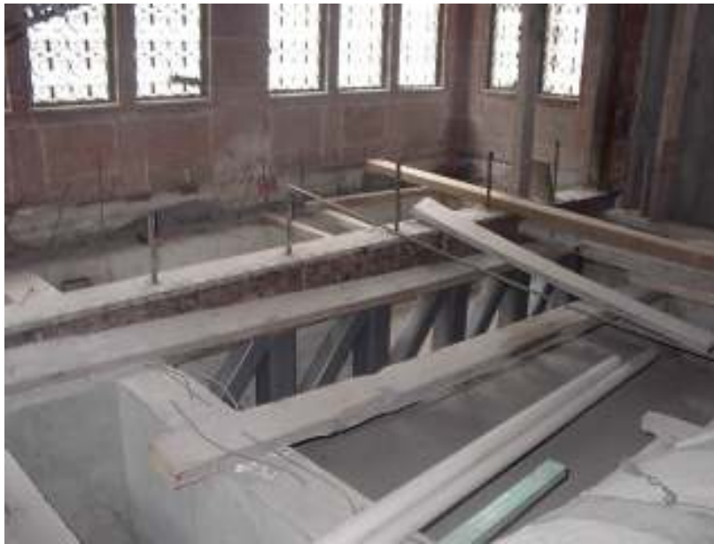
Figura 14a. Empleo de armadura y viga de acero para rigidizar el marco y sujetar tensores.
