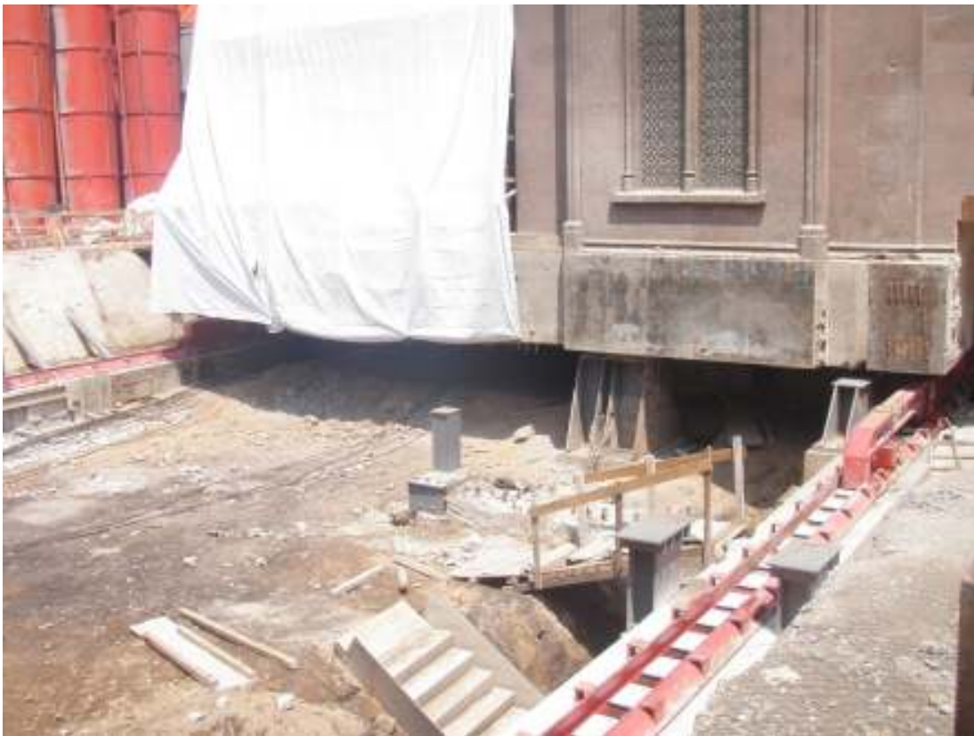
Figura 38a. Apoyos temporales y gatos hidráulicos que sirvieron de soporte a la casa durante dos meses.
