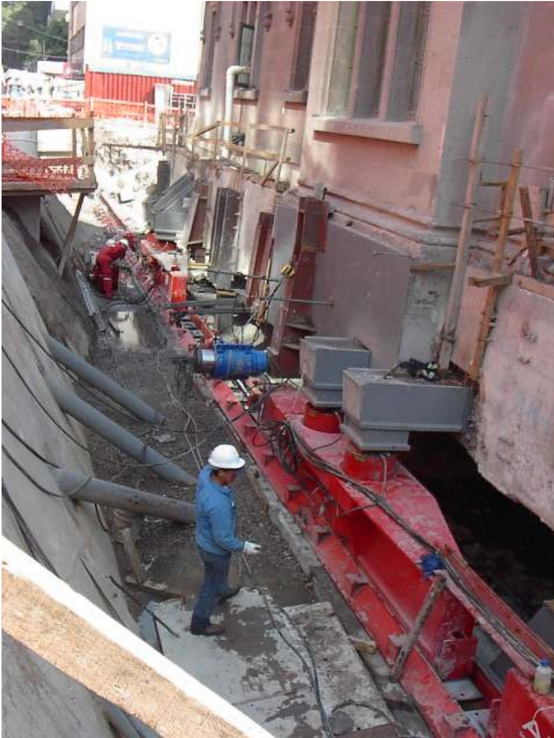
Figura 35. Carril de desplazamiento sobre el eje 4.
