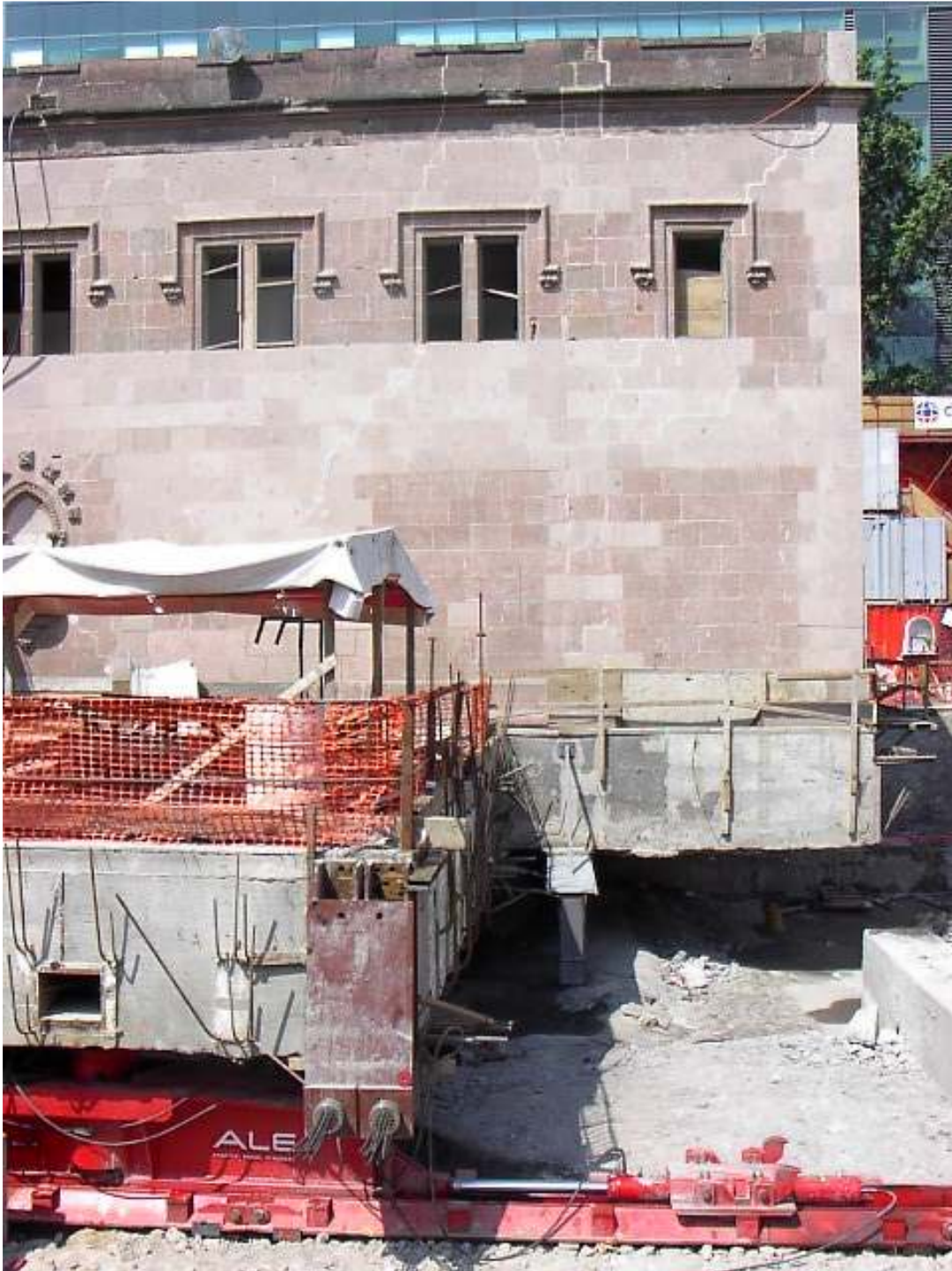
Figura 47. Agrietamientos en fachada oriente.
