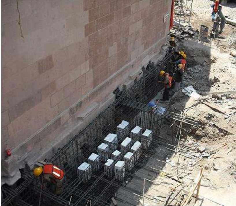
Figura 23b. Detalles de armado y colocación de casetones en losa de recimentación.
