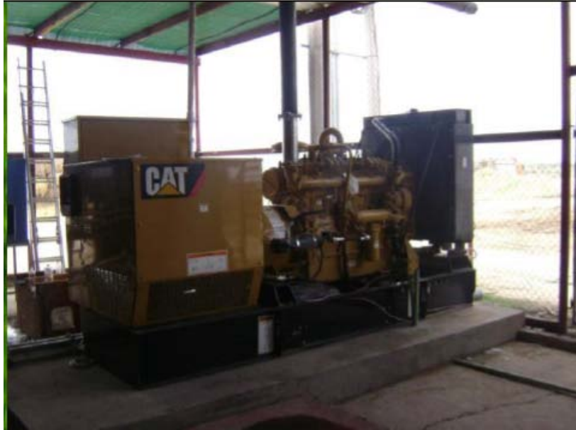
Figura 2.11 Generador de planta de biogás, Torreón.
