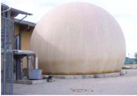
Figura 3.11 Membrana instalada para almacenar biogás excedente [5].
