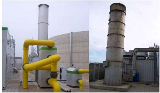
Figura 3.12 Quemadores de biogás [8].
