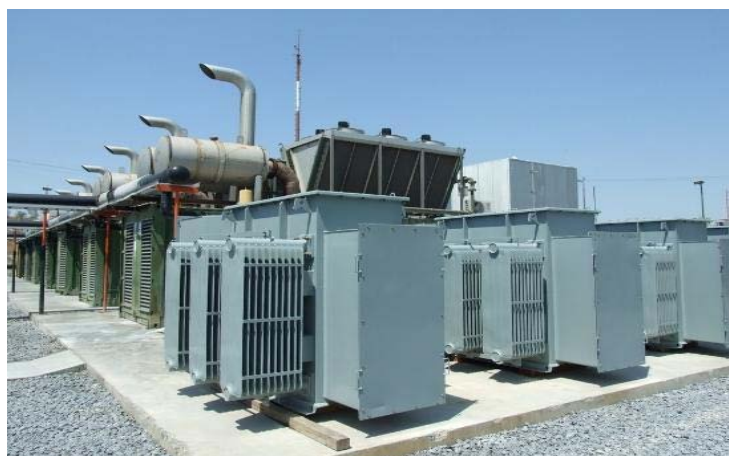
Figura 2.17 Transformadores en la planta Benlesa, Monterrey
