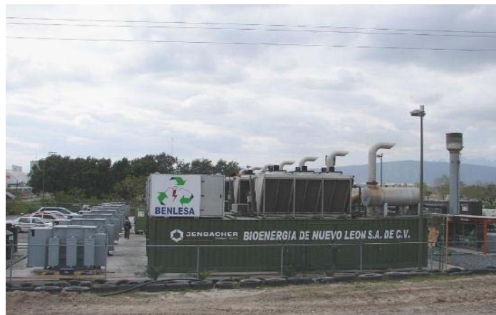
Figura 2.16 Planta de biogás en relleno sanitario en Monterrey
