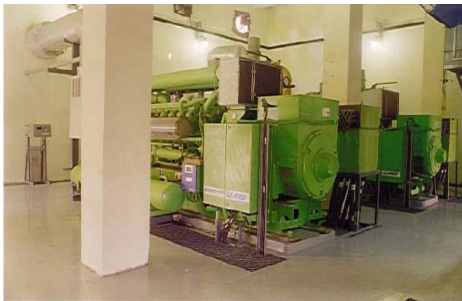
Figura 2.4 Planta de biogás de Kanoria Chem, Ankleshwar.
